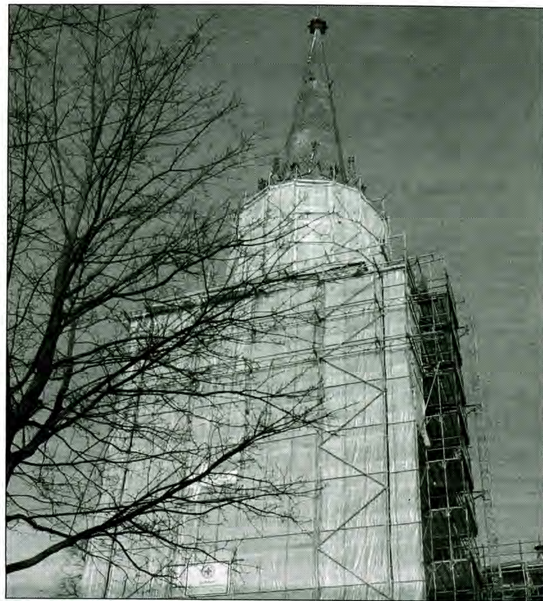
Seit über fünf Jahren steht das Gerüst an der Kirche St. Josef. Erst vor Weihnachten haben die Arbeiter entdeckt, dass die Schäden im Mauerwerk schwerwiegender sind als zunächst angenommen. 80 Prozent der Steine mussten ersetzt werden. Foto: Helmut Thönissen
