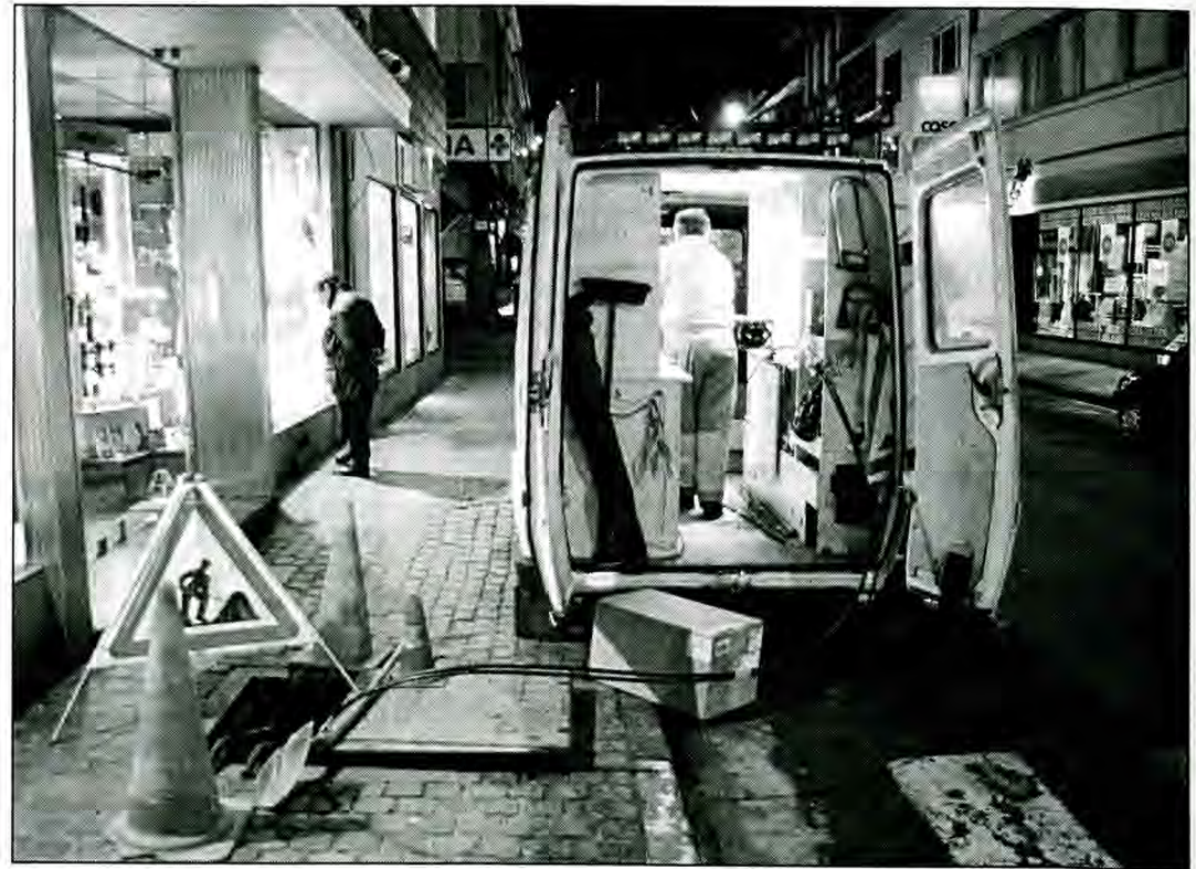
Bis in die späten Abendstunden waren die Techniker von Belgacom in der rue de l'Harmonie in Verviers mit der Reparatur der beschädigten Glasfaserkabel beschäftigt. Foto: GDS
